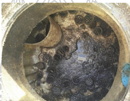
รูปที่ 21 จุดท่อน้ำออกจากระบบบำบัดแบบติดที่ของอาคารโสมสวลี (ส่วนโรงอาหาร) คณะศึกษาศาสตร์
