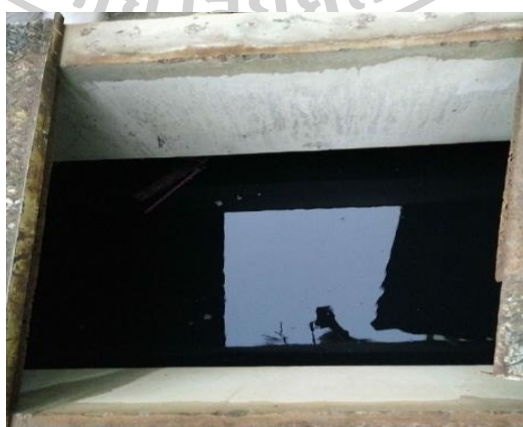
รูปที่ 22 จุดท่อน้ำออกจากระบบบำบัดแบบติดที่ของอาคารวิทยาศาสตร์ 1 คณะวิทยาศาสตร์
