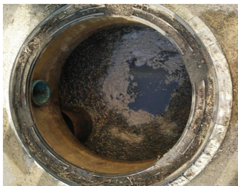
รูปที่ 20 จุดท่อน้ำเข้าระบบบำบัดแบบติดที่ของอาคารโสมสวลี (ส่วนโรงอาหาร) คณะศึกษาศาสตร์
