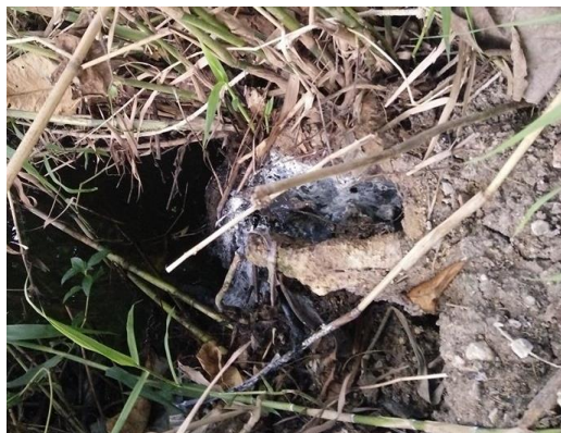
รูปที่ 23 จุดท่อน้ำออกจากระบบบำบัดแบบติดที่ของอาคารศิลป์พีระศรี 2 คณะมัณฑนศิลป์
