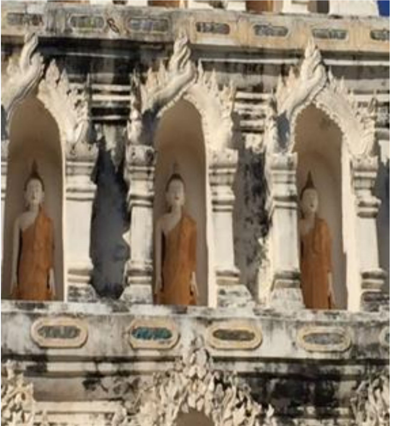
ภาพที่ 18 : รูปแบบซุ้มเคล็ดแบบพม่าที่ประดับจระนำซุ้ม วัดเจดีย์เหลี่ยม
