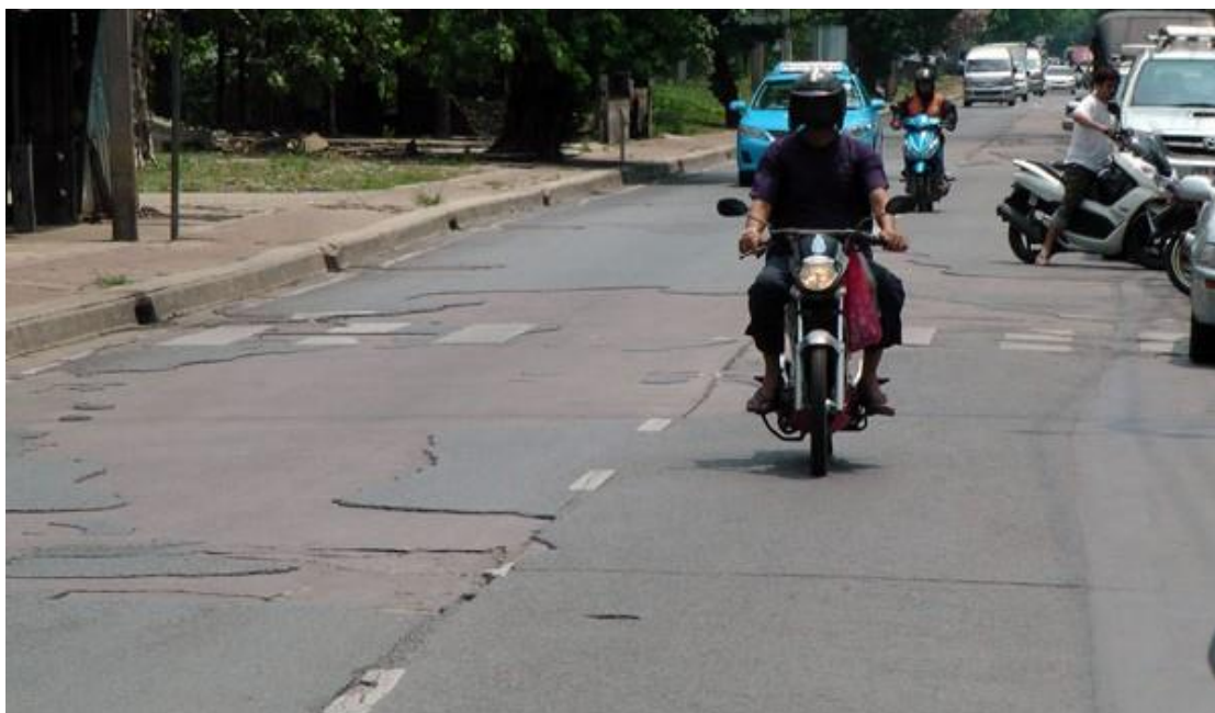
ภาพที่ 4 ถนนพัง ขรุขระตลอดสาย
