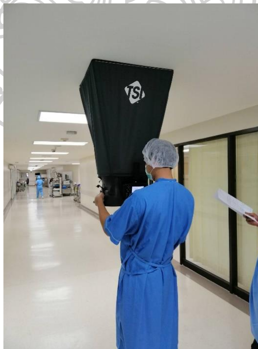
ภาพที่ 13 แสดงการตรวจวัดคุณภาพอากาศตามมาตรฐานห้องผ่าตัด
