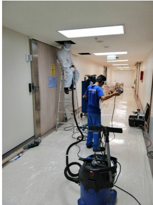
ภาพที่ 14 แสดงการตรวจวัดคุณภาพอากาศตามมาตรฐานห้องผ่าตัด
