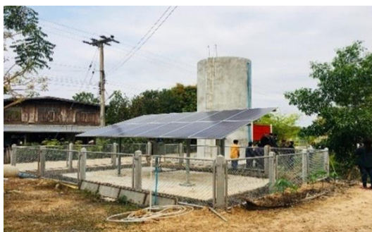
แผงโซลาร์เซลล์ผลิตไฟฟ้าวันละ 30 กิโลวัตต์
