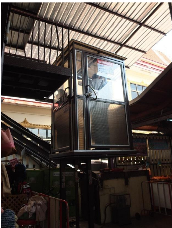
ภาพที่ 113 ลิฟต์สำหรับผู้พิการหรือทุพพลภาพและผู้สูงอายุรวมถึงสตรีมีครรภ์ บริเวณอาคารชั้นเดียว (หมายเลข 1) ตลาดน้ำฝิ่งเหนือ
