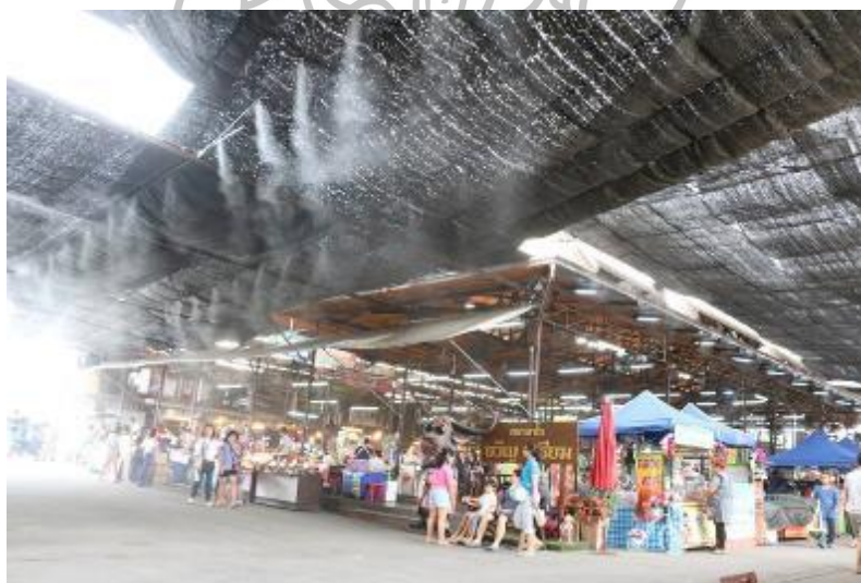
ภาพที่ 118 การติดตั้งการข่ายพรางแสงและระบบไอน้ำบริเวณตลาดน้ำฝิ่งใต้
