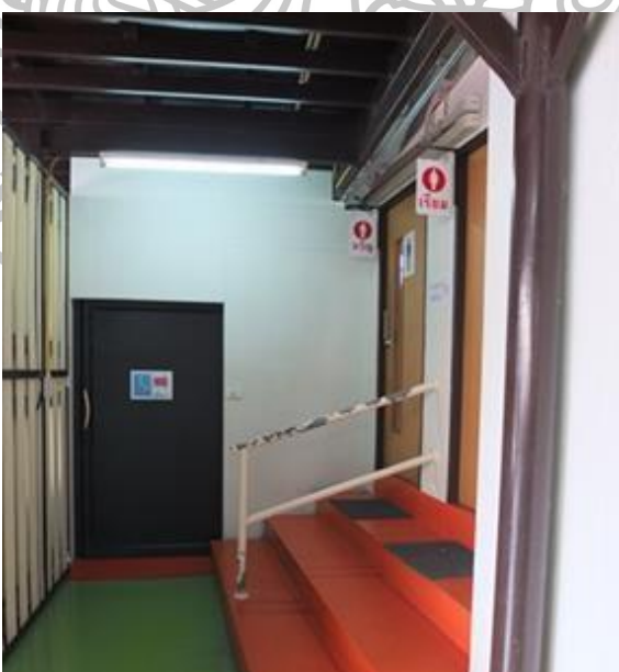
ภาพที่ 114 ห้องน้ำสำหรับผู้พิการหรือทุพพลภาพและผู้สูงอายุ บริเวณอาคารชั้นล่างตลาดน้ำ ขวัญเรียมฝิ่งเหนือ
