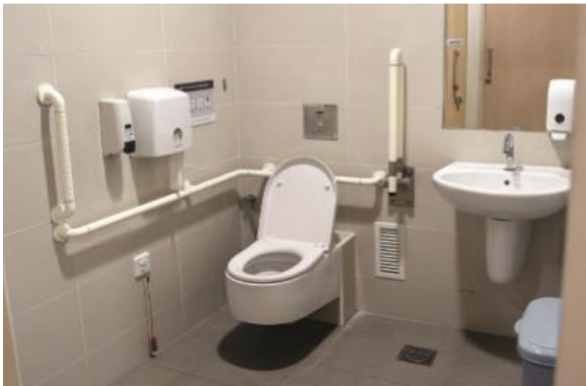
ภาพที่ 29 อุปกรณ์แจ้งเหตุฉุกเฉินภายในห้องน้ำ ที่มา : UD Guide for Public Places, 2016
