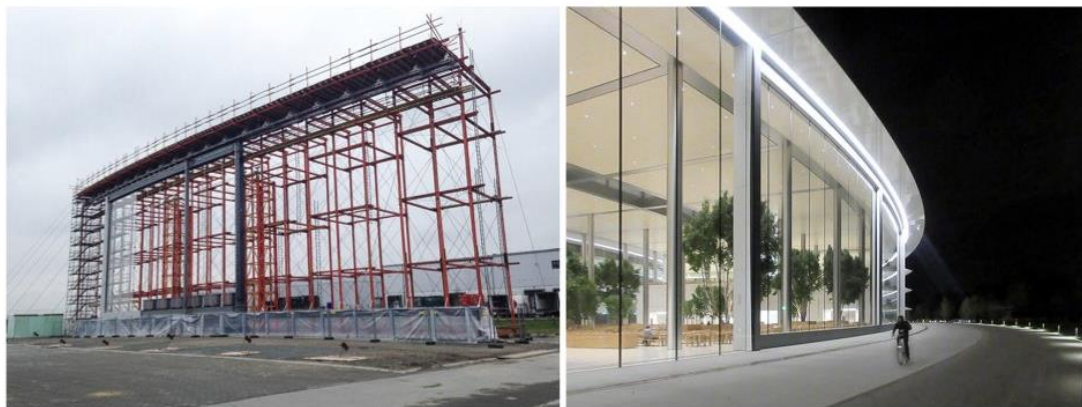
Fig 4. 44 Mockup ประตูปานเลื่อนขนาดใหญ่ และทัศนียภาพเมื่อสร้างเสร็จสมบูรณ์
