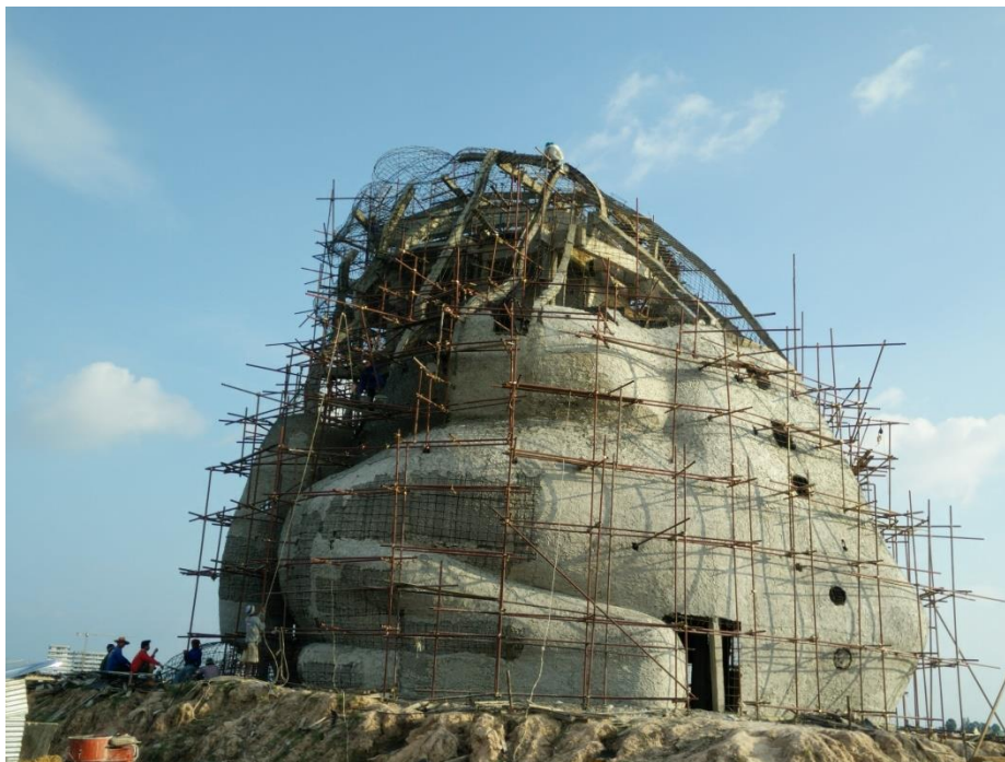
ภาพที่ 46 ภาพถ่ายการก่อสร้างส่วนผนังของอาคารพิพิธภัณฑ์พญาคันคาก ที่มา : สำนักงานโยธาธิการและผังเมืองจังหวัดยโสธร, ม.ป.ป.
