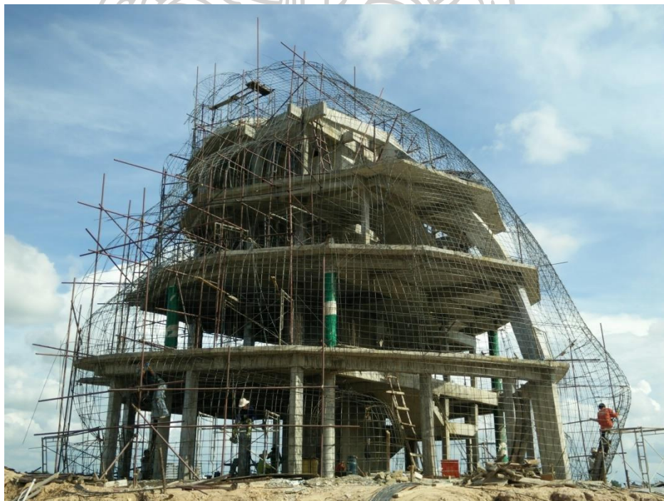
ภาพที่ 45 ภาพถ่ายการก่อสร้างส่วนโครงสร้างของอาคารพิพิธภัณฑ์พญาคันคาก
