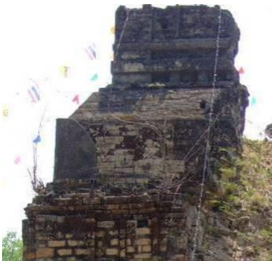
ภาพที่ 172 ชั้นหลังคาเรือนธาตุ พระธาตุอุโมงค์
