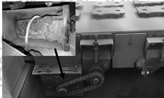
รูปที่ 32 มอเตอร์ก่อนปรับปรุง
