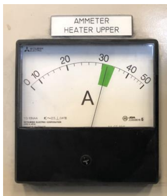
รูปที่ 22 มาตรฐานการตรวจสอบกระแสไฟฟ้า
