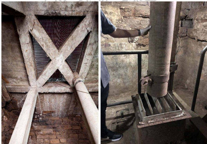
ภาพที่ 83 มีพัดลมระบายอากาศจากกรุชั้นล่างมาที่กรุชั้นบน และระบายอากาศจากกรุชั้นบนผ่านท่อสู่โถงกลางชั้นบนสุดต่อไป
