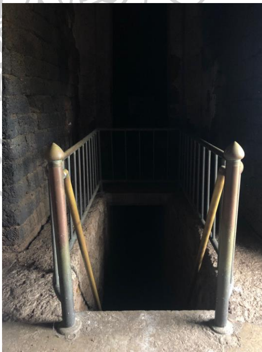
ภาพที่ 88 ระบบไฟฟ้าขัดข้องทำให้แสงสว่างและระบบระบายไม่ทำงาน ทำให้มืดทั้งบริเวณ อากาศไม่ได้ระบายออก เกิดกลิ่นคาวคละคลุ้ง
