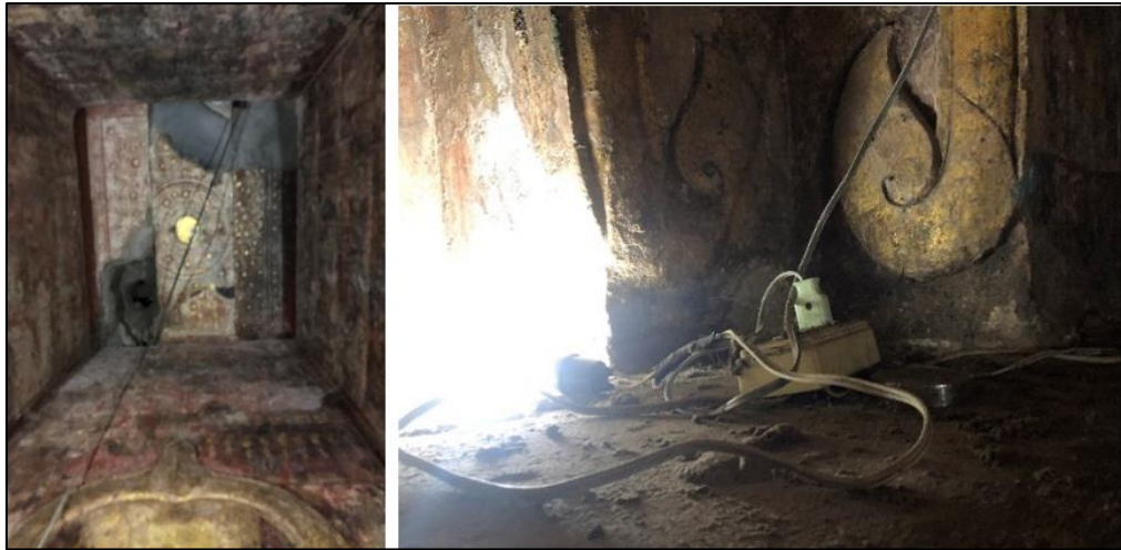
ภาพที่ 94 แสงไฟฉายไปที่ภาพจิตรกรรมฝาผนังโดยตรง สายไฟและปลั๊กไฟที่วางไม่เป็นระเบียบ การต่อสายไฟจากรูบนเพดานจากรูชั้นบนลงสู่รูชั้นล่าง
