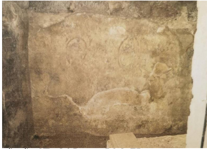
ภาพที่ 71 ความชื้นที่ขึ้นผิวจิตรกรรม ผิวนูน และศิลาแลง เป็นคราบฝ้า คราบเกลือ กรูชั้นบน (ที่มาภาพ: กลุ่มอนุรักษ์จิตรกรรมและประติมากรรม, (2563), รายงานการสำรวจสภาพจิตรกรรมฝาผนังกรุพระปรางค์วัดราชบูรณะ.)
