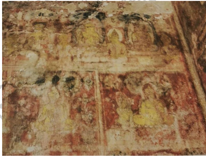
ภาพที่ 76 สภาพความชำรุดของจิตรกรรมฝาผนัง กรุชั้นล่าง ความชำรุดของชั้นสีโป่งพองและสีซีดจาง (ที่มาภาพ: กลุ่มอนุรักษ์จิตรกรรมและประติมากรรม, (2563), รายงานการสำรวจสภาพจิตรกรรมฝาผนังกรุพระปรางค์วัดราชบูรณะ.)
