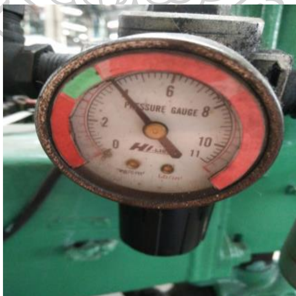
ภาพที่ 37 เกจวัดแรงดันที่ติดตั้งบริเวณเครื่องจักร
