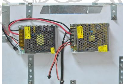
รูปที่ 3.20 Power Supply 3A และ Power Supply 5A
