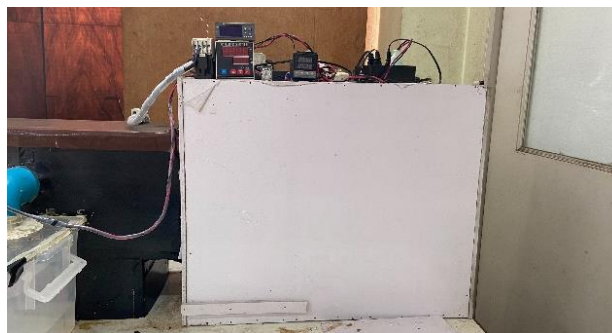
รูปที่ 3.2 ห้องควบคุมอุณหภูมิ
