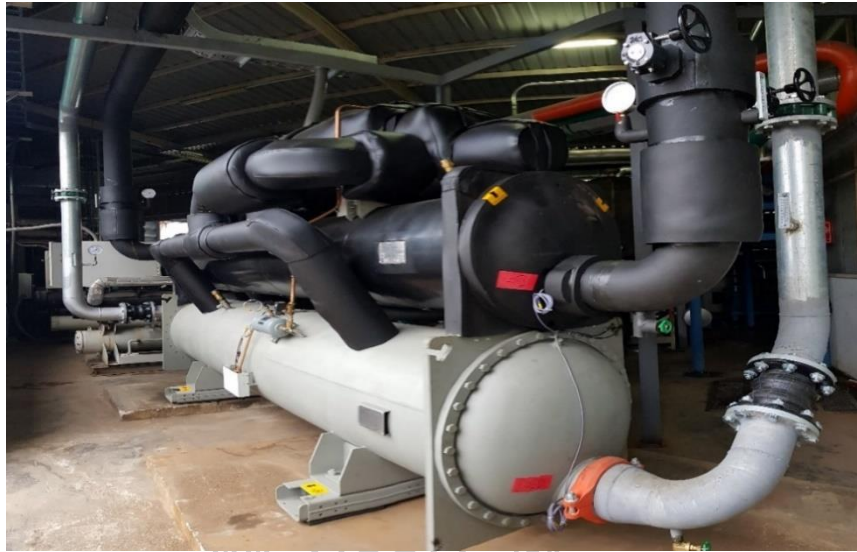
รูปที่ 77 การติดตั้งเครื่องผลิตน้ำเย็นประสิทธิภาพสูง
