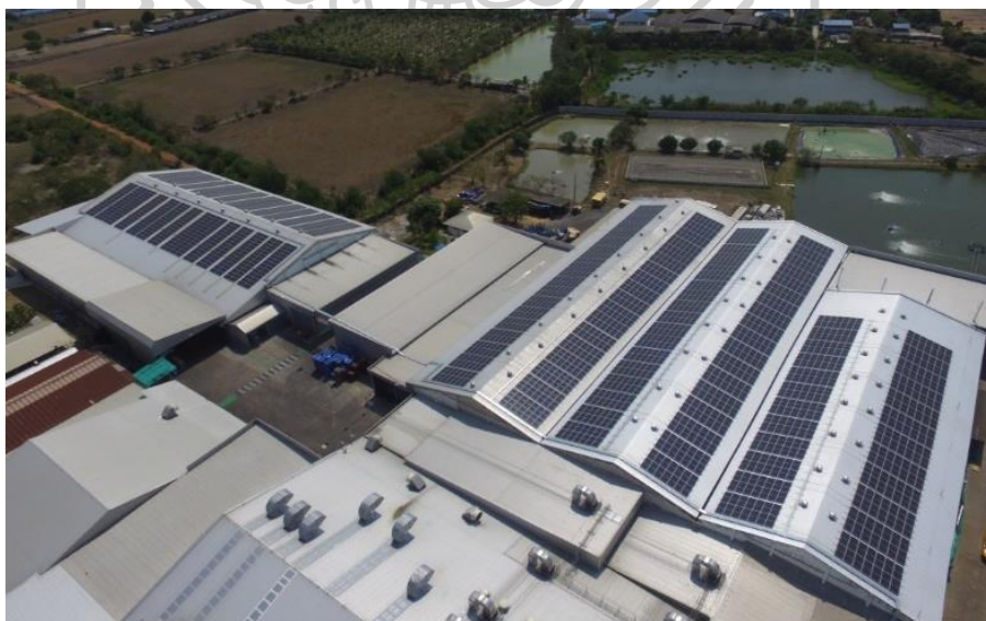
รูปที่ 71 การติดตั้งแผงผลิตไฟฟ้าจากเซลล์แสงอาทิตย์
