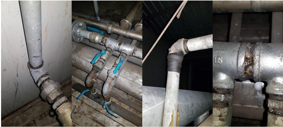
รูปที่ 63 จุดรั่วไหลของอากาศอัด
