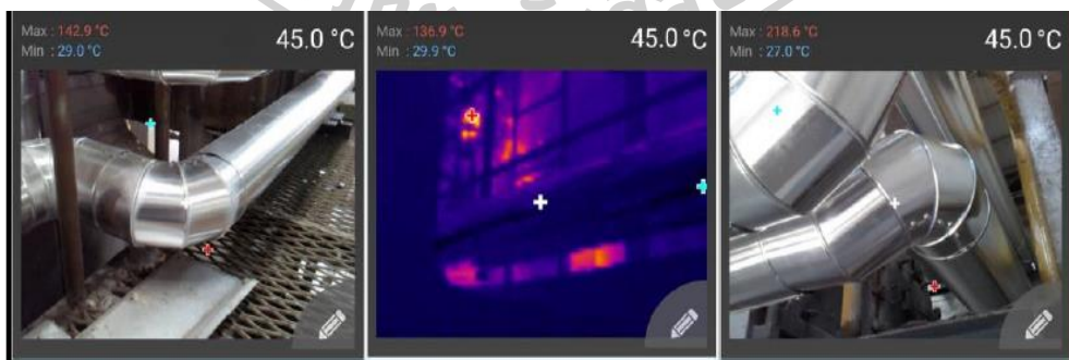
รูปที่ 75 อุณหภูมิผิวท่อจ่ายไอน้ำหลังการปรับปรุง
