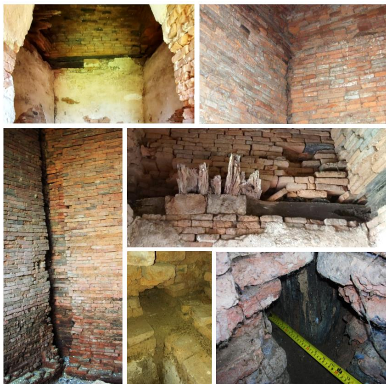
ภาพที่ 143 ผนังกำแพงรับน้ำหนักแบบก่อตั้งฉากกับพื้น และตัวอย่างหลักฐานการตั้งเสาไม้ที่มุมห้องเรือนธาตุและโครงสร้างฝ้าเพดาน
