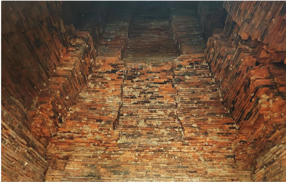
ภาพที่ 18 เทคนิคการก่อสร้างส่วนเหนือห้องเรือนธาตุเจดีย์ประธาน วัดลังกา
