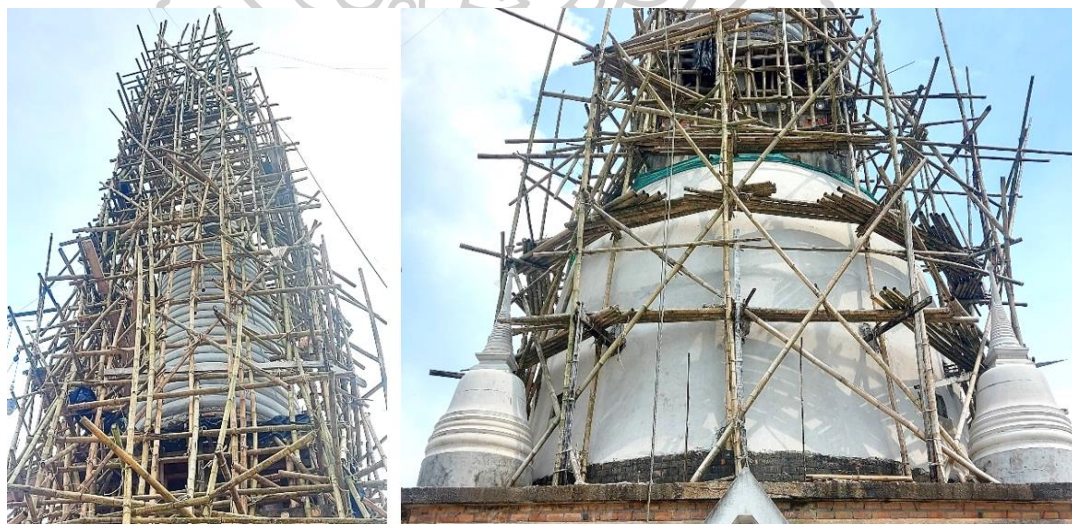
ภาพที่ 157 นั่งร้านโครงสร้างไม้ไผ่ ขณะก่อสร้างเจดีย์วัดธรรมมาวุธาราม ระนอง
