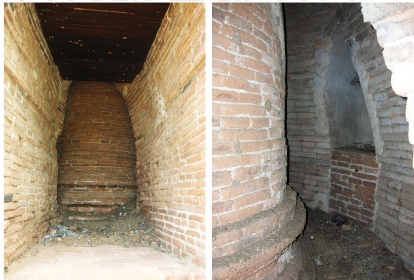
ภาพที่ 105 เทคนิคการก่อสร้างภายในห้องเรือนธาตุเจดีย์ประธาน วัดจงกลม
