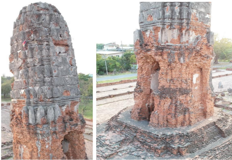
ภาพที่ 28 เทคนิคการก่อสร้างโดยรอบองค์เจดีย์ประธาน วัดโลกยสุทธา
