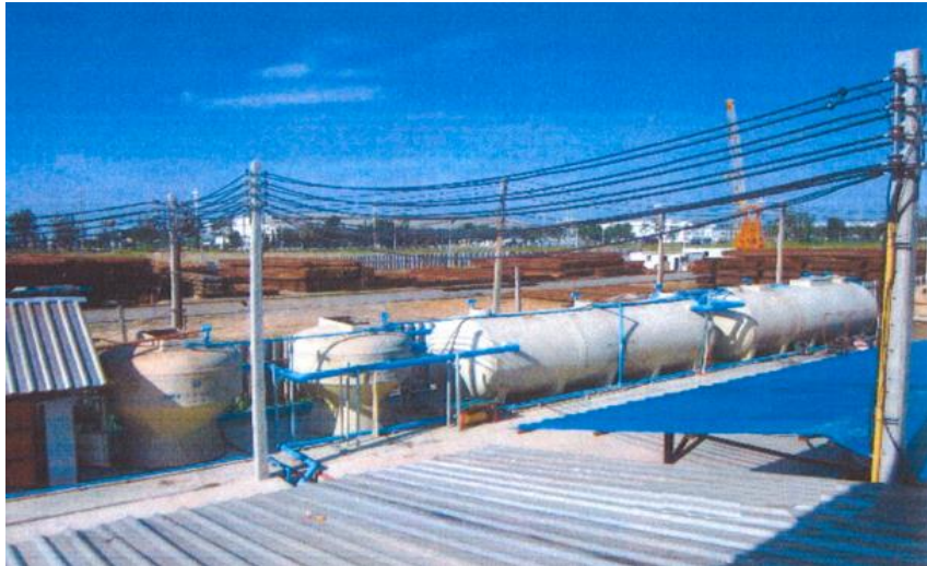
รูปภาพที่ 4.23 ระบบบำบัดน้ำเสียภายในที่พักแรงงานก่อสร้างของ โครงการ ก
