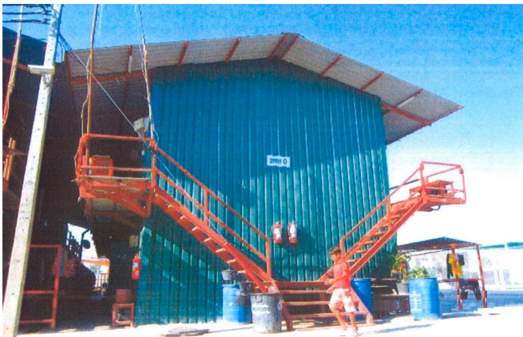
รูปภาพที่ 4.11 ติดตั้งถังดับเพลิงของ โครงการ ก
