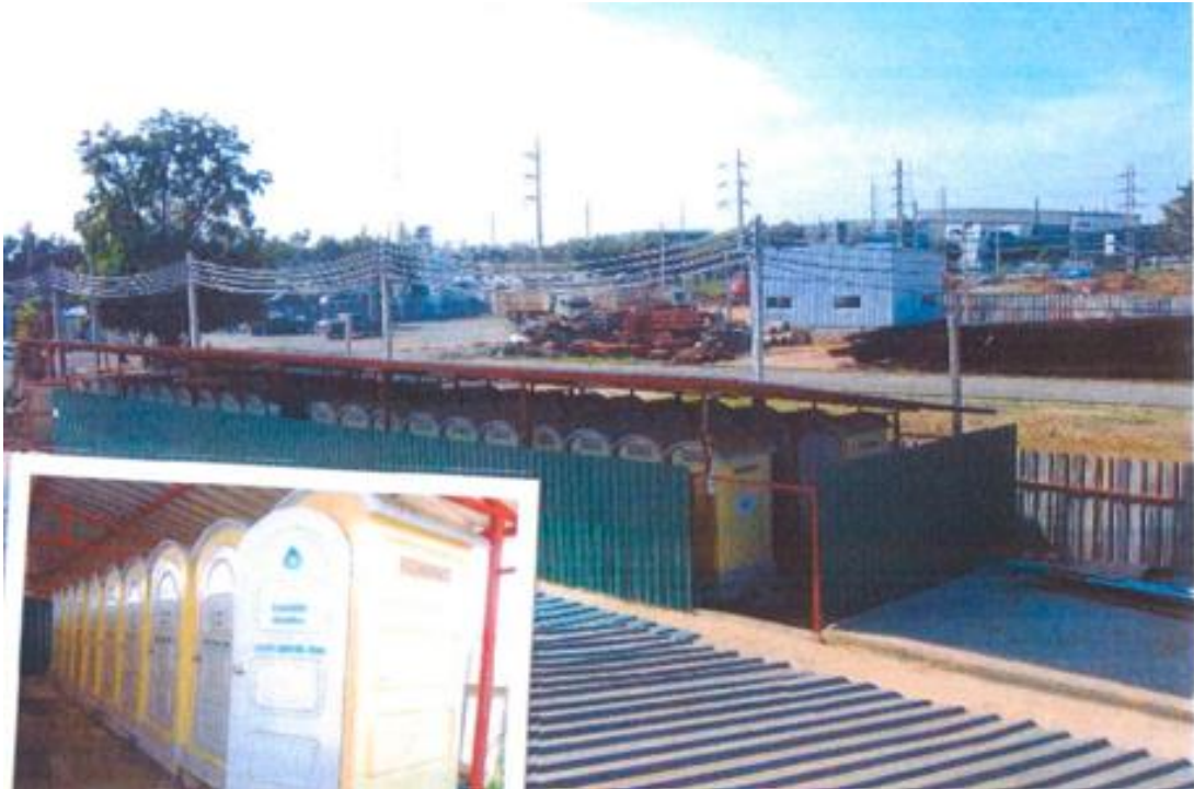
รูปภาพที่ 4.2 พื้นที่ห้องน้ำภายในที่พักอาศัยแรงงานก่อสร้างของโครงการ ก
