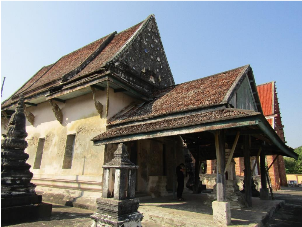
ภาพที่ 155 พระอุโบสถวัดเมืองใหม่ มีการทำชายคาปีกนกล้อมรอบอาคาร และมีการทำมุขลดได้ชื่อบริเวณด้านหน้าของอาคาร
