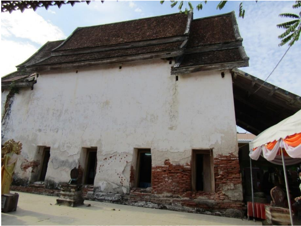
ภาพที่ 153 พระอุโบสถเก่าวัดอินทาราม มีการทำแผงหลังคาจันทันทับบริเวณด้านหน้าของอาคาร
