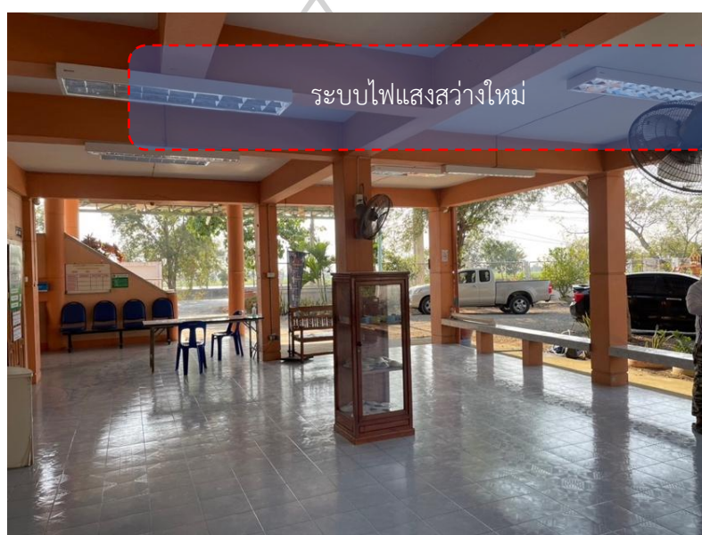
ภาพที่ 116 ปรับปรุงระบบไฟฟ้าแสงสว่างเดิมที่ชำรุด
