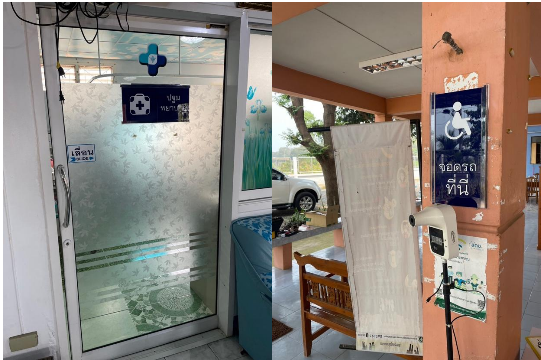
ภาพที่ 121 ภาพที่ติดตั้งระบบป้ายสัญลักษณ์
