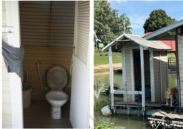
ภาพที่ 35 แสดงระบบบำบัดน้ำเสีย จากส้วมที่มีระบบบ่อเกรอะ
