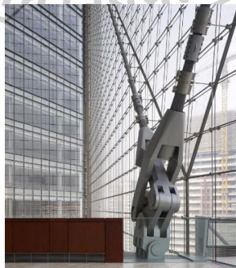
ภาพที่ 65 โครงเคเบิลซิ่ง (Cable Net System)
