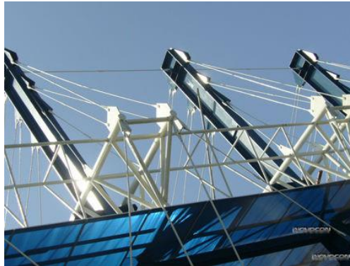
ภาพที่ 63 โครงสร้างเหล็กรับแรงดึง (Tension Rod System)
