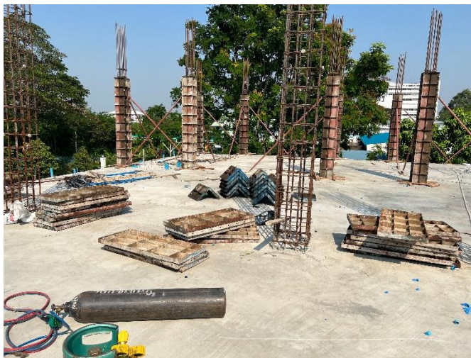
ภาพที่ 38 ไม้แบบเสาอาคารที่ไม่สามารถติดตั้งได้จากการสั่งขนาดผิด 01/03/2565 วันที่ 2 มีนาคม 2565
