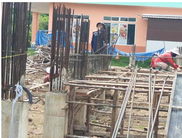
ภาพที่ 32 ไม้แบบหมดคนงานบางส่วนไม่มีงานทำ 07/09/2564
