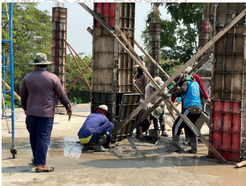
ภาพที่ 51 ไม้แบบเสาที่แตกจากการไม่ติดตั้งตัวล็อคไม้แบบเสาชั้น 2 04/03/2565
