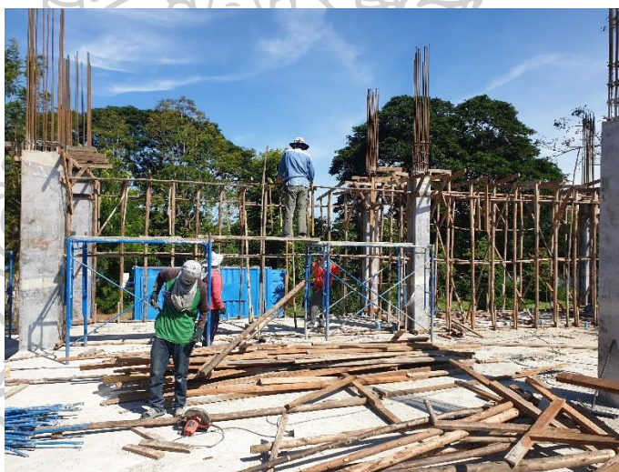
ภาพที่ 34 การวางไม้ค้ำยันแบบคานชั้น 2 23/11/2564
