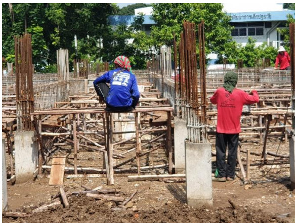
ภาพที่ 23 คนงานก่อสร้างผูกเหล็กเสริมคานชั้น 1 30/08/2564
