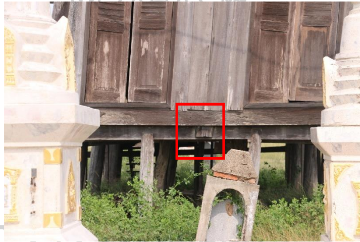
ภาพที่ 81 โคนเสาดั้งที่ตั้งบนรอด อุโบสถวัดคู้งตำหนัก
