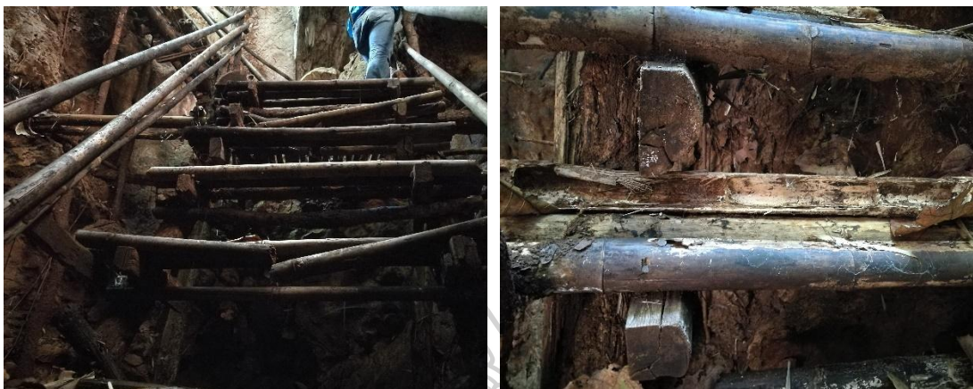
ภาพที่ 25 การเสื่อมสภาพของบันไดเข้าแหล่งโบราณคดี
