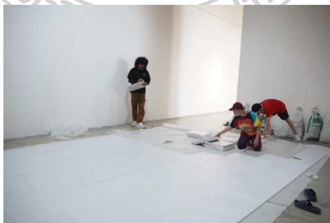
ภาพที่ 165 ทีมงานกำลังติดตั้งพื้นด้วยแผ่นพลาสติก ที่มา: ภาพถ่ายโดย ธนธร สรรพกิจจำนง
