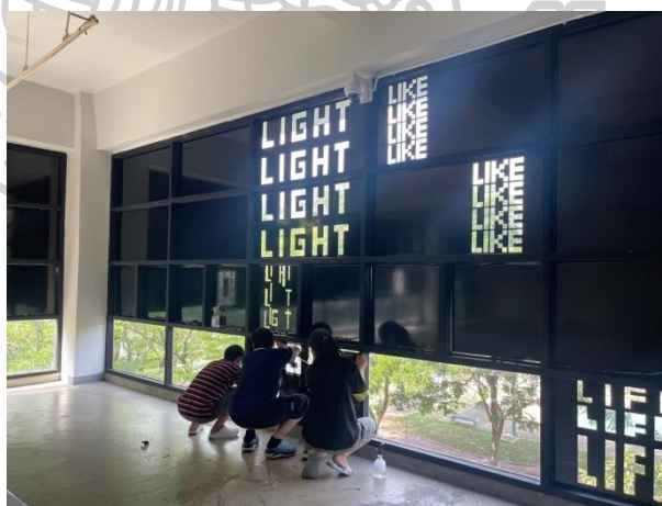
ภาพที่ 228 ทีมงานกำลังติดตั้งสติ๊กเกอร์ PVC บนผนังกระจก ที่มา: ภาพถ่ายโดย ชนธร สรรพกิจงานง
