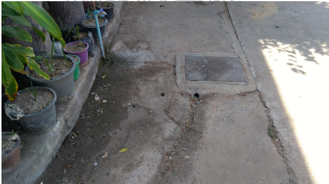
รูปภาพที่ 78 ระบบน้ำดีและรางระบายน้ำ
