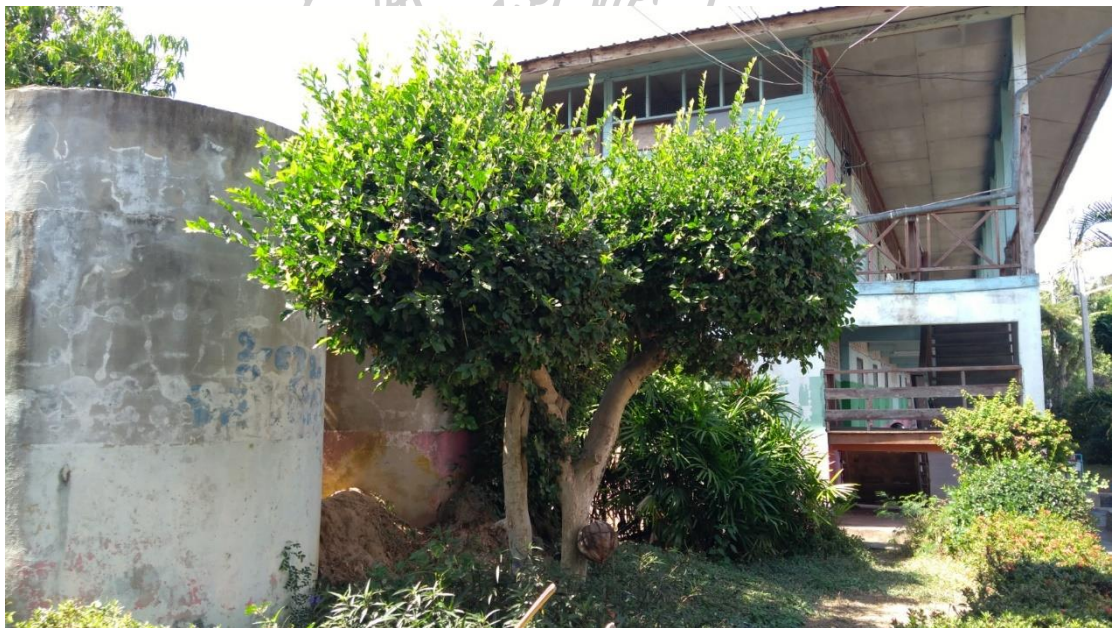
รูปภาพที่ 75 ถังเก็บน้ำฝนเดิม
