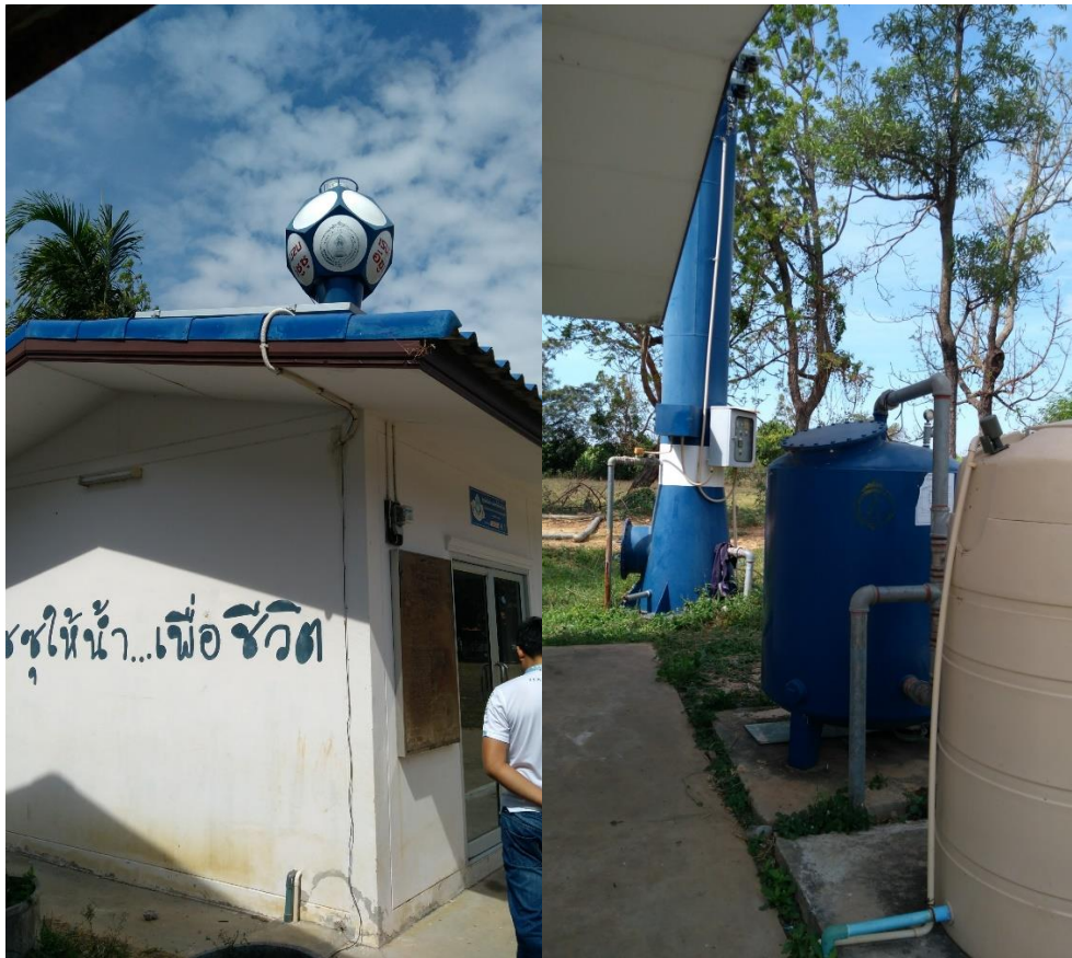
รูปภาพที่ 77 ถังเก็บน้ำดื่ม
