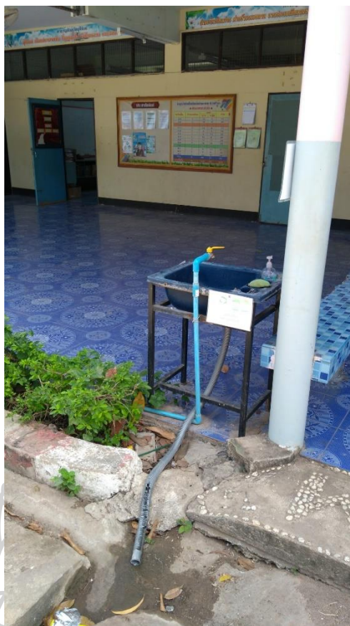
รูปภาพที่ 79 ระบบน้ำดีและรางระบายน้ำ
