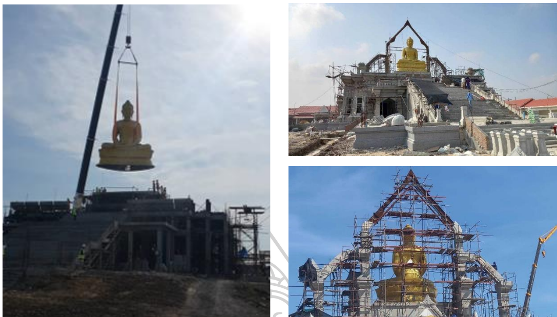
ภาพที่ 7 ตัวอย่างปัญหาการก่อสร้างซุ้มเรือนแก้วเนื่องจากอยู่บนที่สูง
