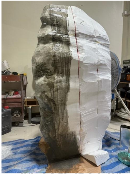
ภาพที่ 40 ขั้นตอนที่ 7.7 ทาเรซินเคลือบโฟมด้านในและซับใยแก้ว ในจุดที่ต้องการวางชุดมอเตอร์
