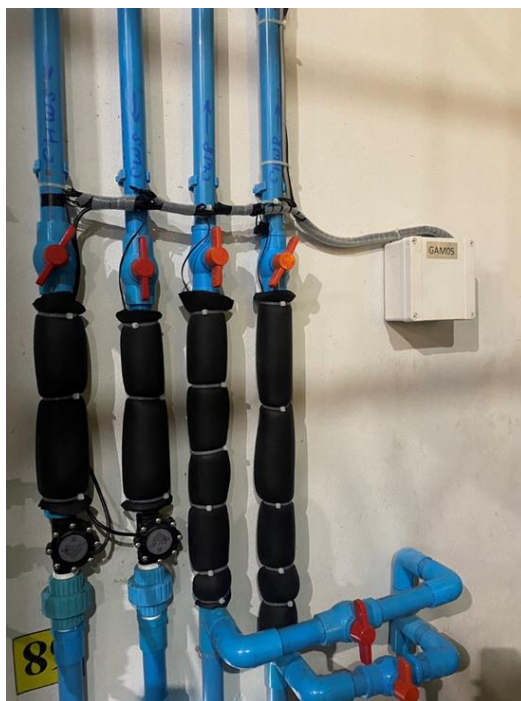
ภาพที่ 54 ท่อน้ำเข้า-น้ำออกที่มีการติดตั้งอุปกรณ์ IoT และตัวควบคุม
