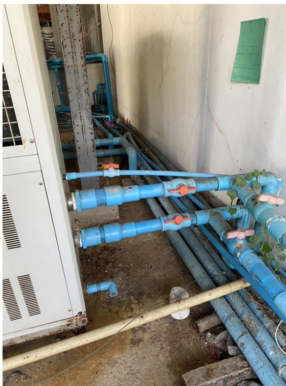
ภาพที่ 59 การเดินท่อน้ำซิลเลอร์ก่อนปรับปรุง
