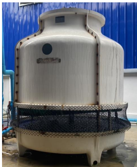
ภาพที่ 29 เครื่องทำความเย็น (Cooling System)
