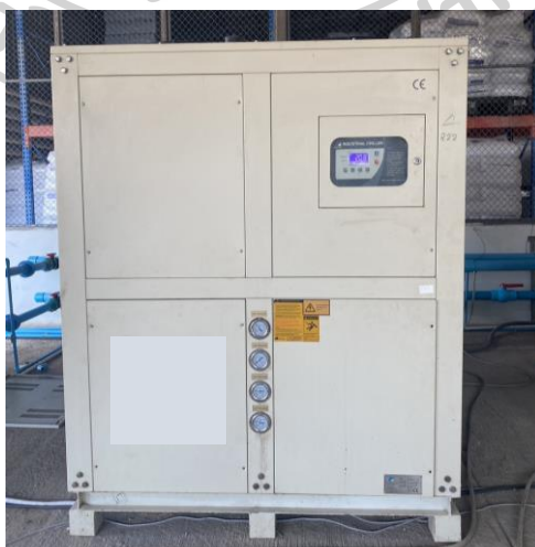
ภาพที่ 30 เครื่องซิลเลอร์ (Chiller)
