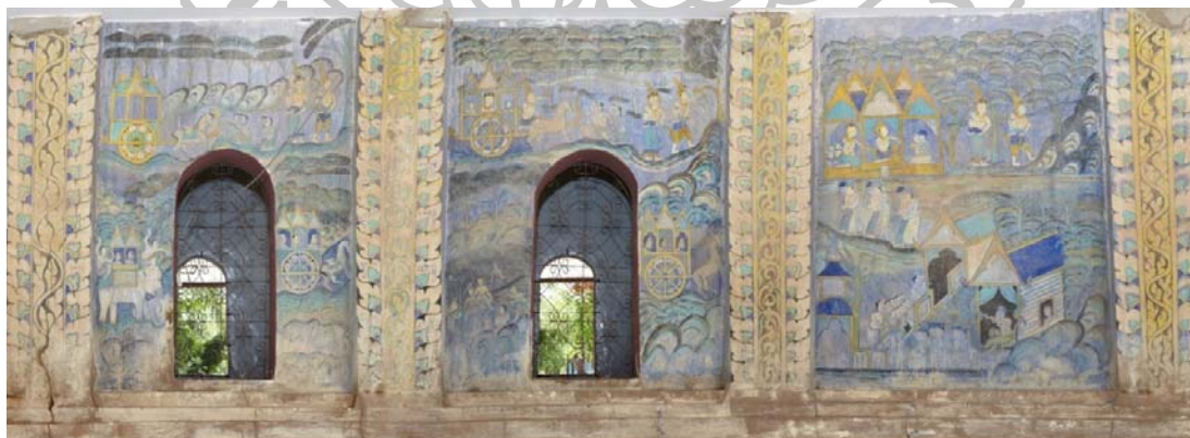
ภาพที่ 330 ผนังด้านทิศเหนือหรือผนังด้านซ้ายพระประธาน
