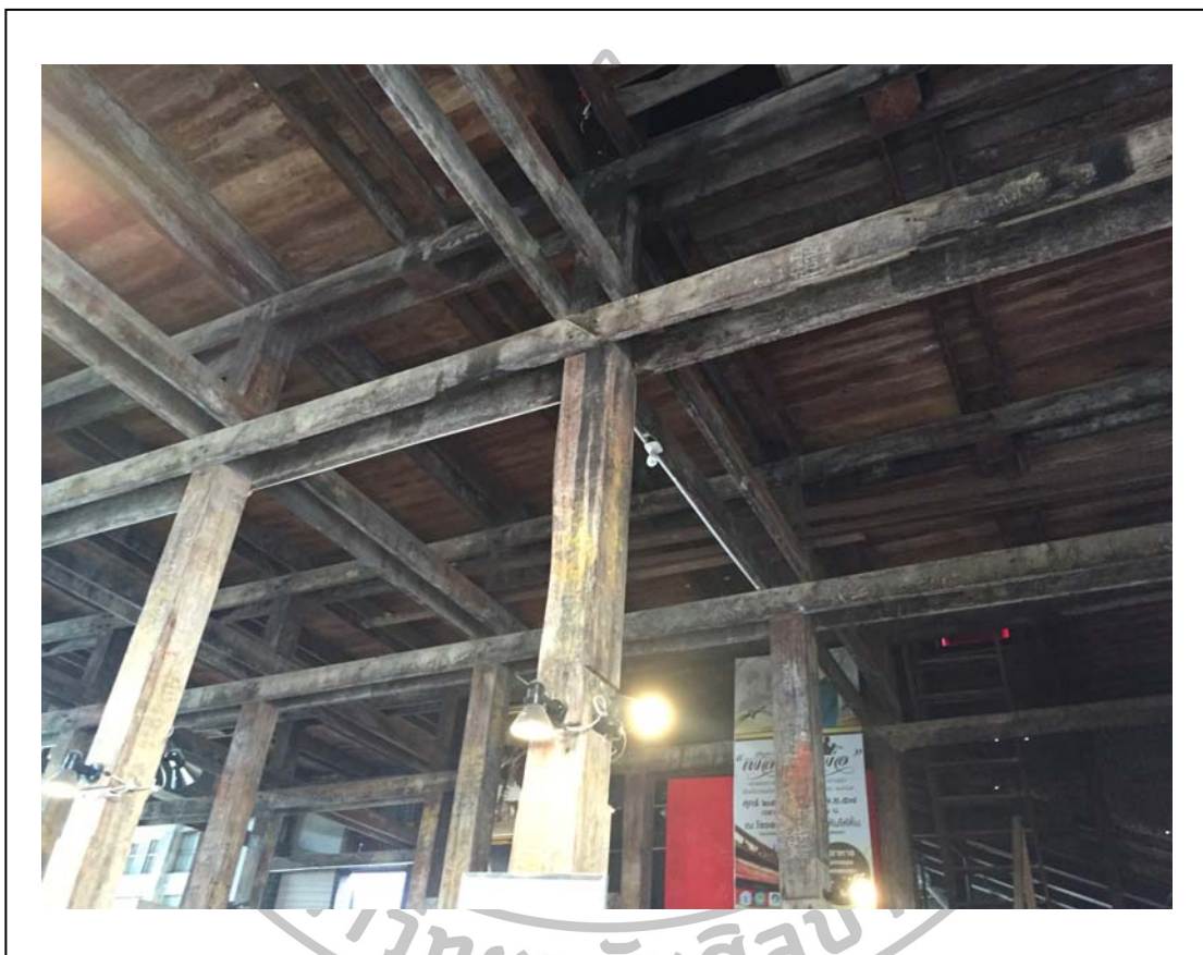
ภาพที่ 38 โครงสร้างอาคาร โรงสีเก่า “หับโห้หิน”
