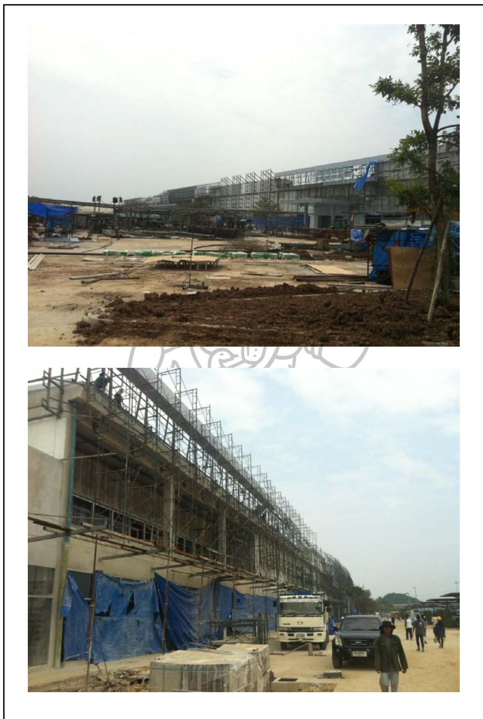
ภาพที่ 40 ภาพถ่ายแสดงงานก่อสร้างส่วนผนังตกแต่งด้านหน้าอาคาร
