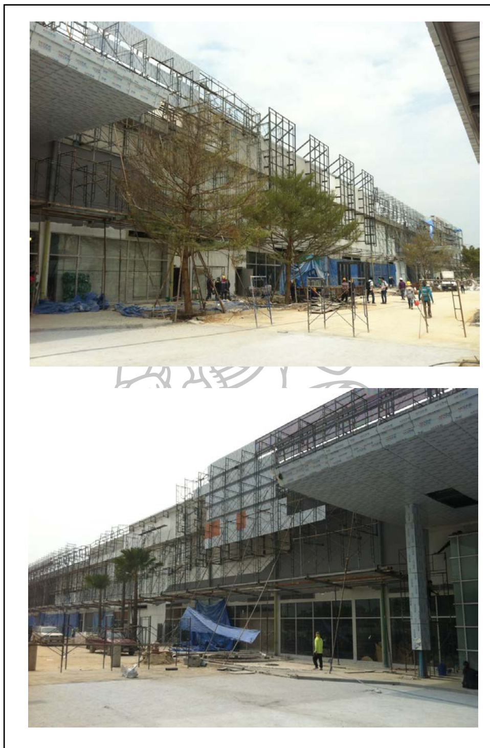
ภาพที่ 38 ภาพถ่ายแสดงงานก่อสร้างส่วนผนังตกแต่งหน้าอาคาร
