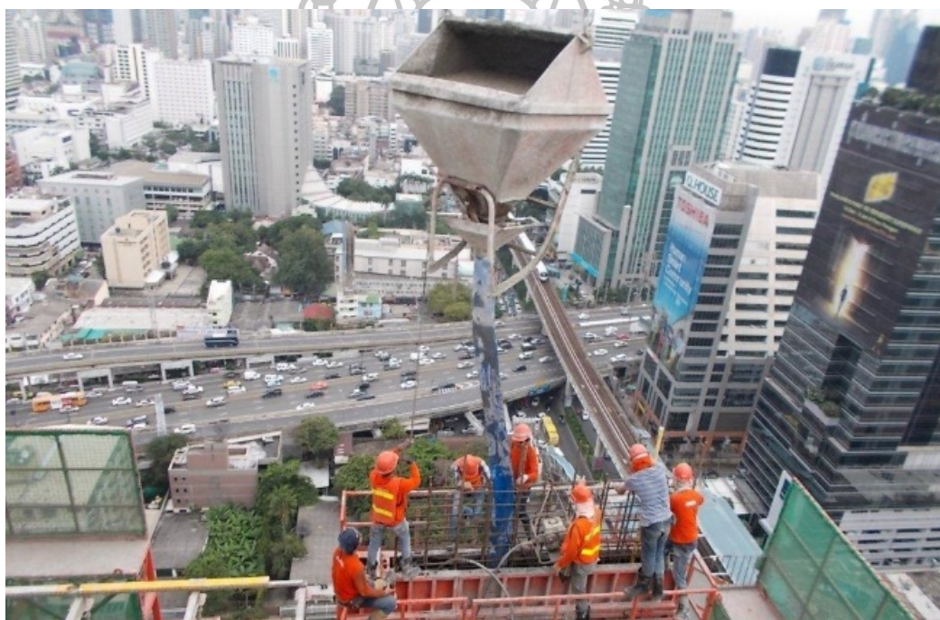
รูป 110 การปฏิบัติงานตาม Work Method Statement (การเทเสา)
