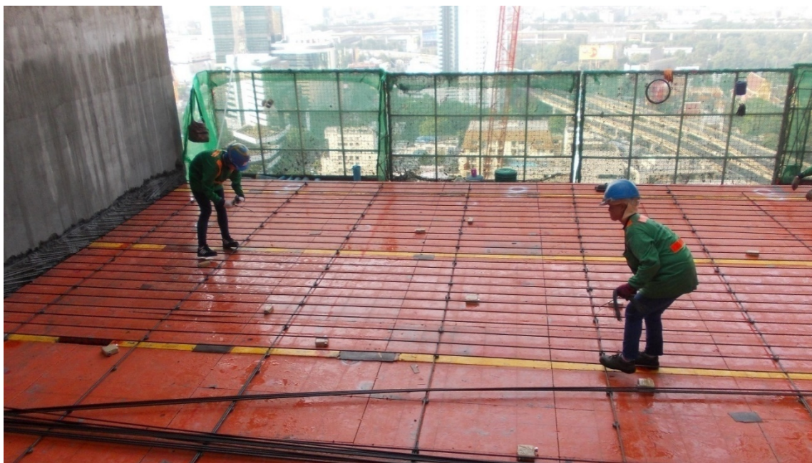
รูป 111 การปฏิบัติงานตาม Work Method Statement (งานพื้น)
