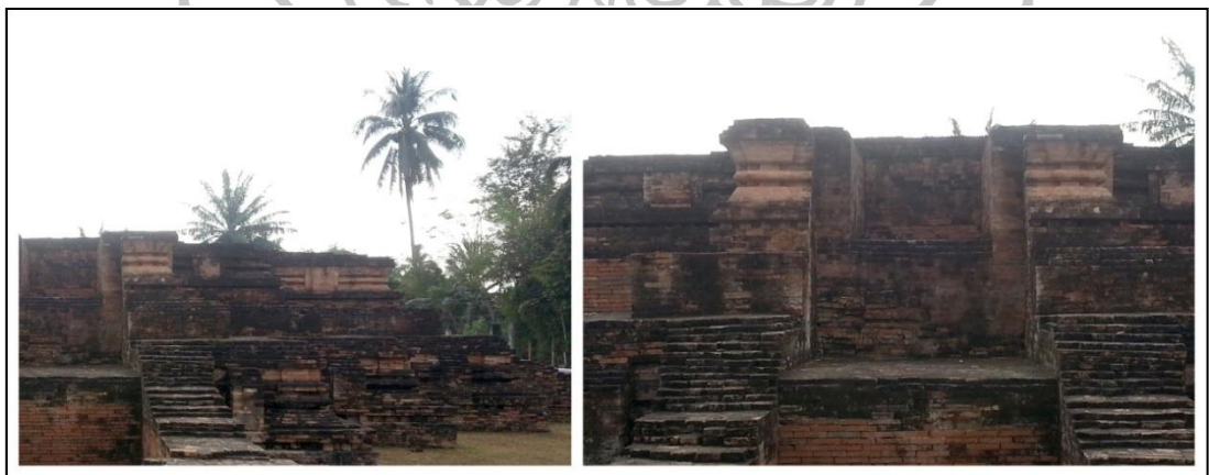
ภาพที่ 195 แสดงรายละเอียดส่วนฐานของอาคารวัดหลง ด้านทิศตะวันตก
