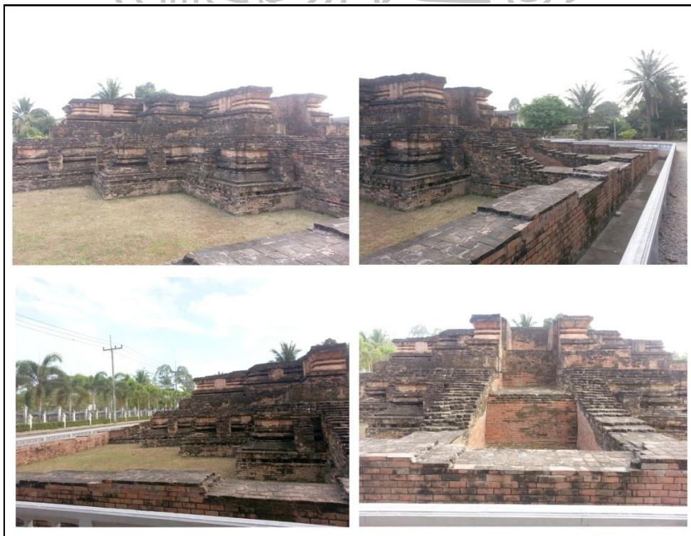
ภาพที่ 197 แสดงรายละเอียดส่วนฐานของอาคารวัดหลง ด้านทิศใต้
