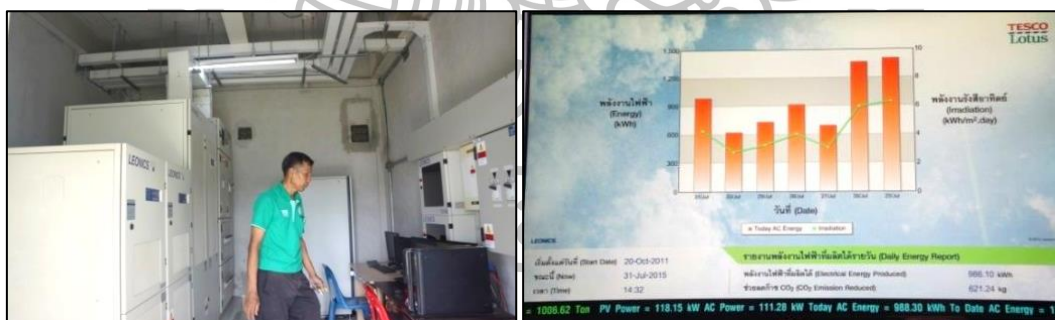
ภาพที่ 15 แสดงห้องควบคุม และหน้าจอแสดงผลการผลิตพลังงานแสงอาทิตย์ อาคาร Zero Carbon Store Tesco Lotus (ตลาดโลตัส) (ถ่ายโดยผู้วิจัย ณ อาคาร Zero Carbon Store Tesco Lotus เมื่อกรกฎาคม 2558)
